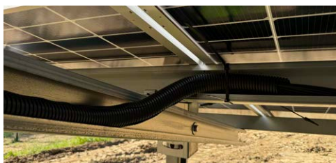
Saubere Kabelführung in Modulträgerschiene für minimalen Material- und Montageaufwand
