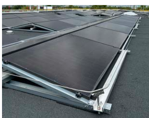
Vorbereitet für Anbringung eines Absturzicherungssystems
